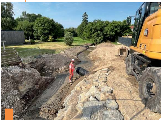
Le ruisseau du Fougeray est visible depuis juin de l'autre côté de la rue du Dr Laënnec.
